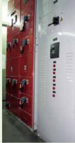
上圖：淺水灣影灣園的功率 因數矯正設備
